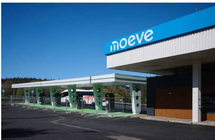
Electrolinera en el área servicio de Ameixeira Norte.
